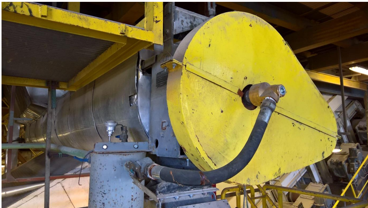
1. kép: a berendezés hajtás felőli vége a kazántól távolabb, hűtővíz elvezetéssel
