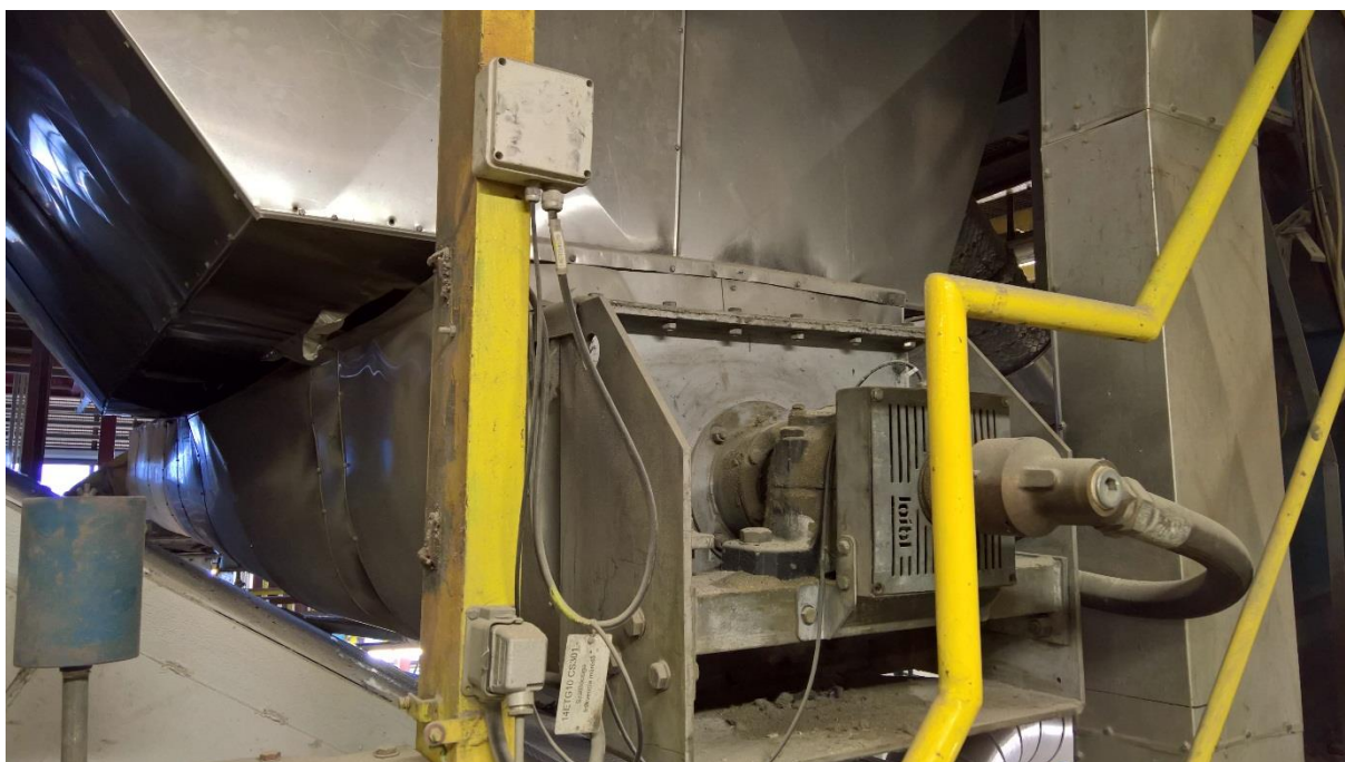
2. kép: berendezés kazán alatti, hajtással átellenes vége hűtővíz bevezetéssel
